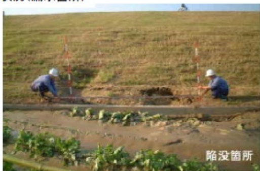
点検状況(漏水箇所)
