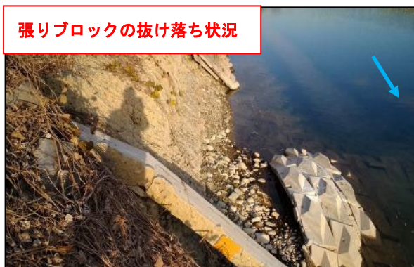
根固めブロックの脱落
