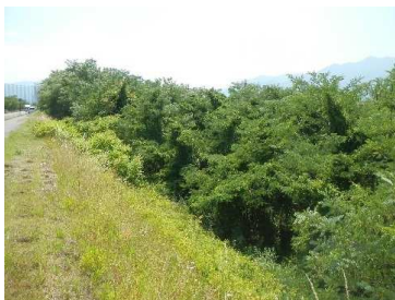
樹木繁茂状況（近景）
