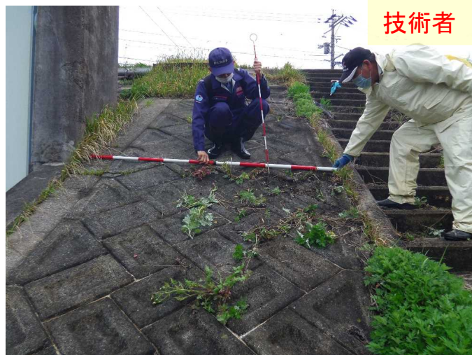
護岸変状確認
