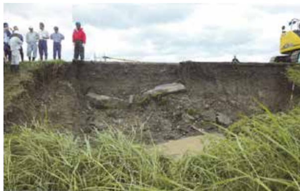
写真－1 のり面崩落直後の様子
