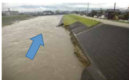
写真－４ 洪水後の護岸の崩壊（護岸の下部から基礎にかけての流失）
