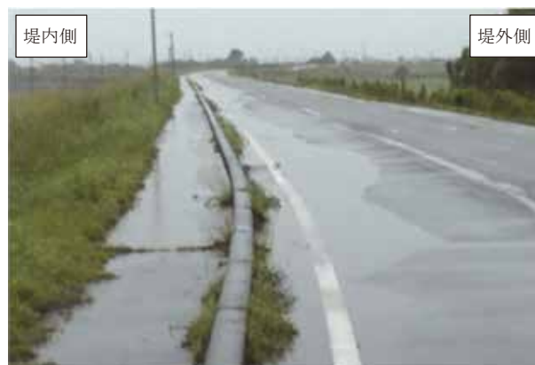
写真－2 のり面崩落以前の通常の降雨時の天端の様子
